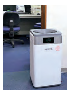
中高職員室には対角線の両端に各1台のHESTAエアクリンを置いている
